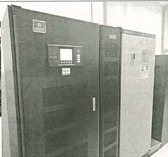
厨房 UPS 电源
