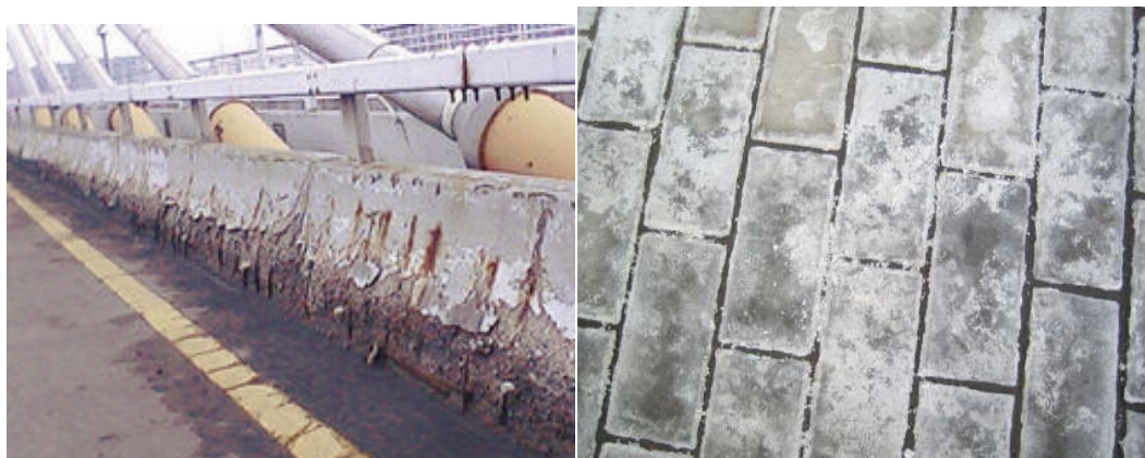
融雪剂腐蚀桥梁架构 融雪剂腐蚀地面外表
