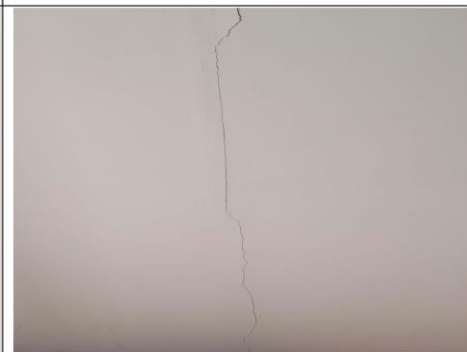
图4.1-20 9单元601屋面板板底裂缝
