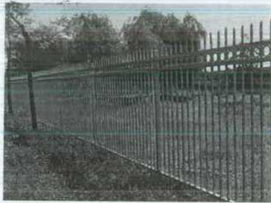
现状铁栏杆位移
