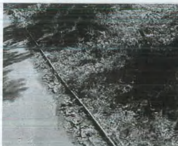
现状止水带已损坏
