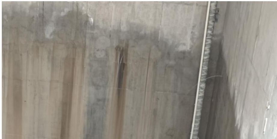
图 3.2 分水口蝶阀室渗水现状
