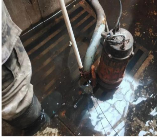
图 2.1 井室水泵现状
