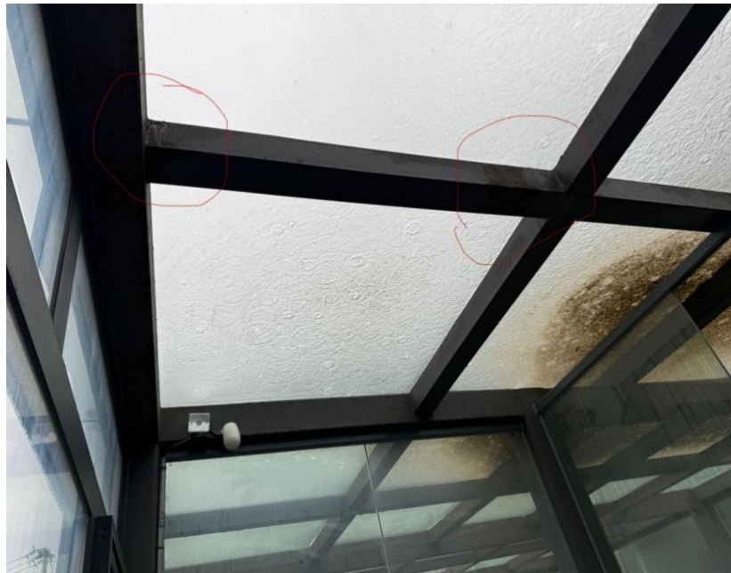
图 7.1 蝶阀室玻璃顶现状
