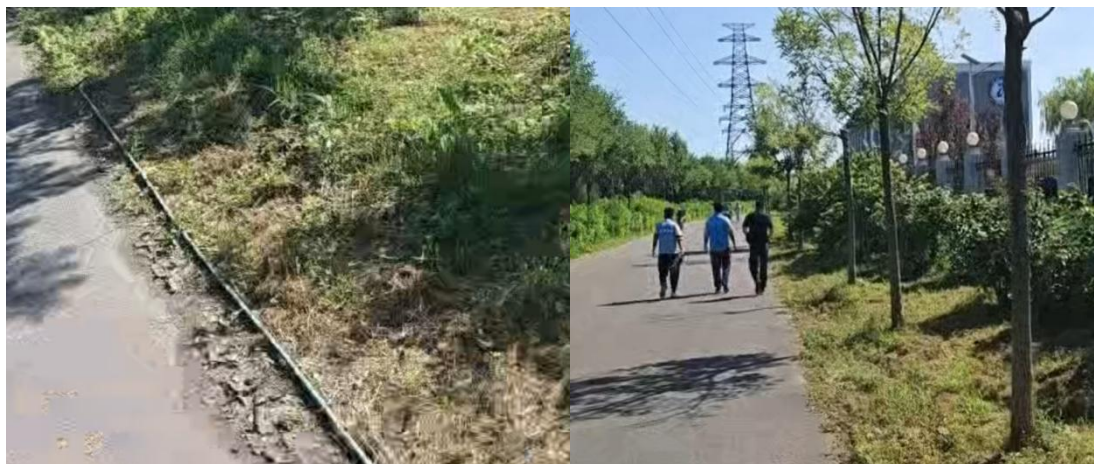
现状止水带已损坏
