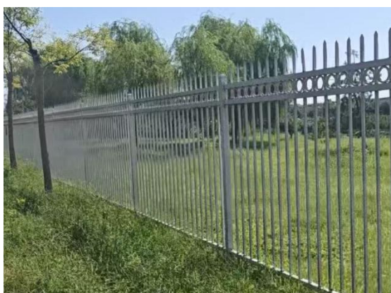
现状铁栏杆位移
