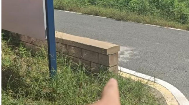
现状霹裂砖挡墙
