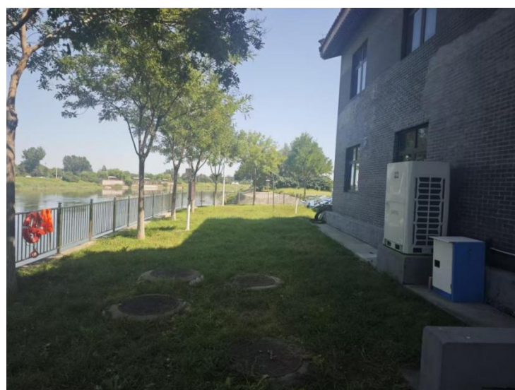
现状办公楼背面空调外机
