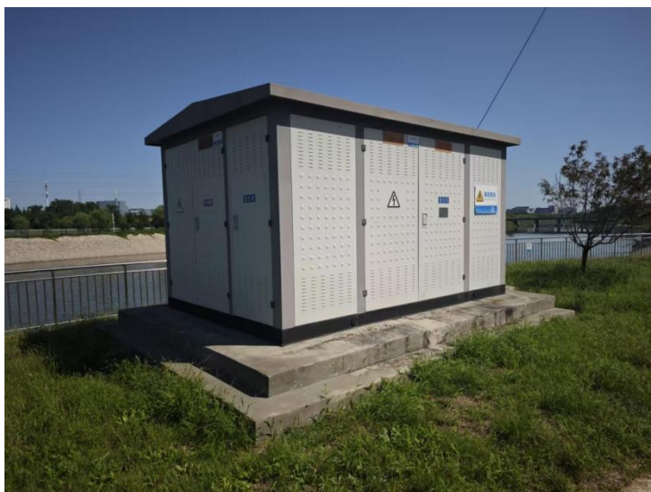
变压器室现状图
