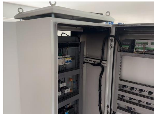
图 9 分洪道闸系统设备
