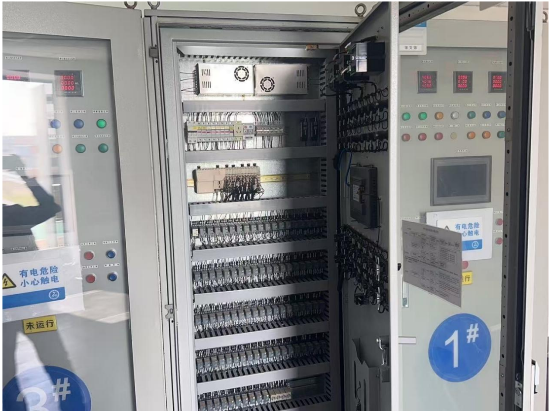
图 16 马驹桥闸配电室
