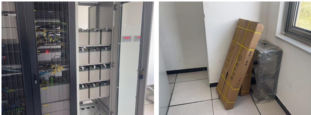
图 17 新河闸机房 UPS 和机柜
