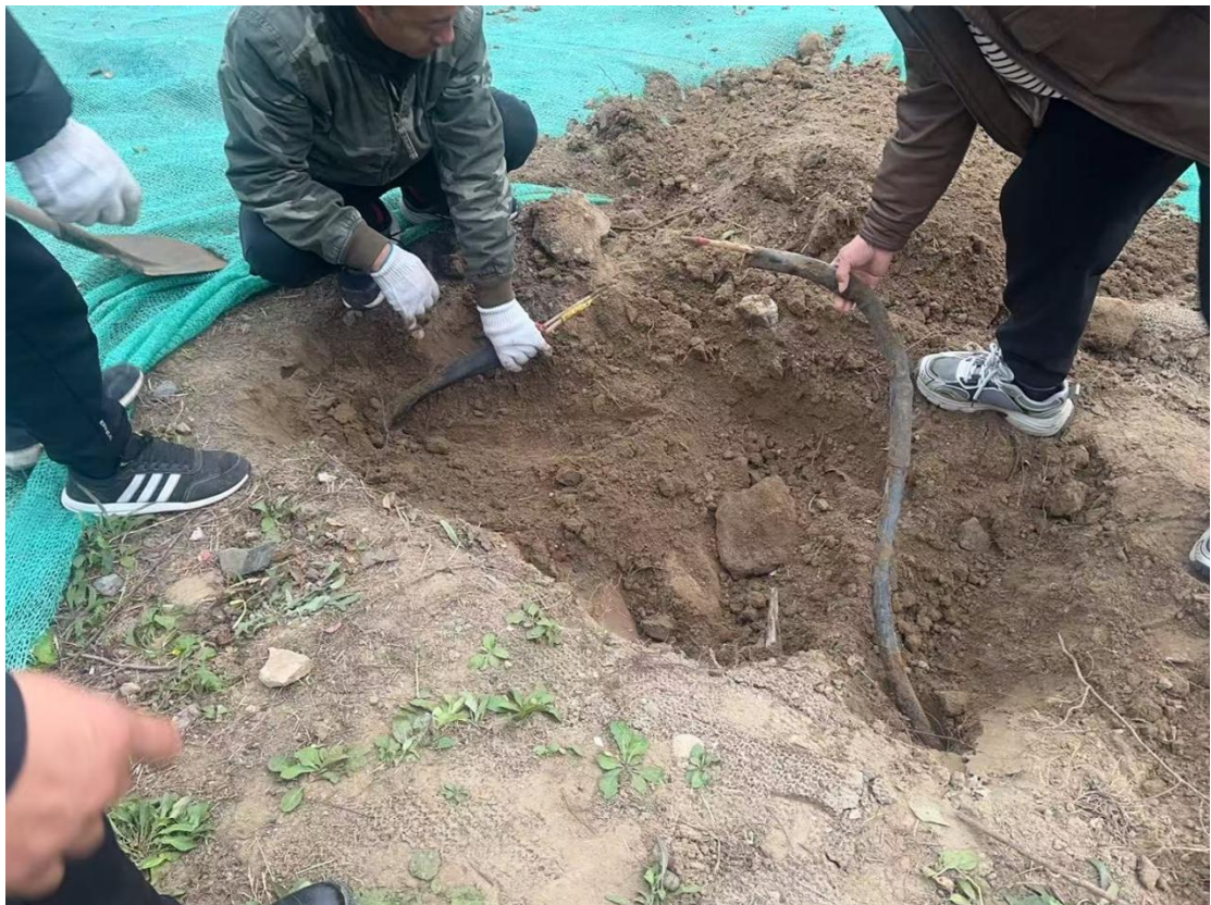
图 13 凉水河管理处通信光缆
