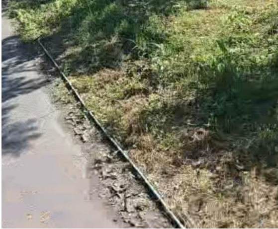
现状止水带已损坏
