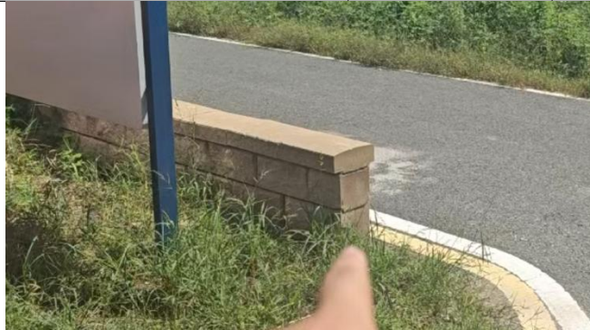
现状霹裂砖挡墙
