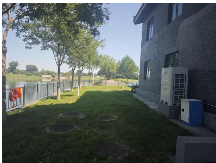
现状办公楼背面空调外机
