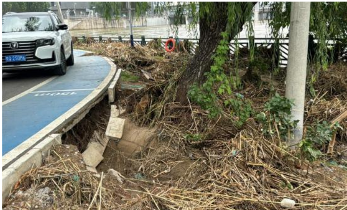
向阳闸下游路基损毁
