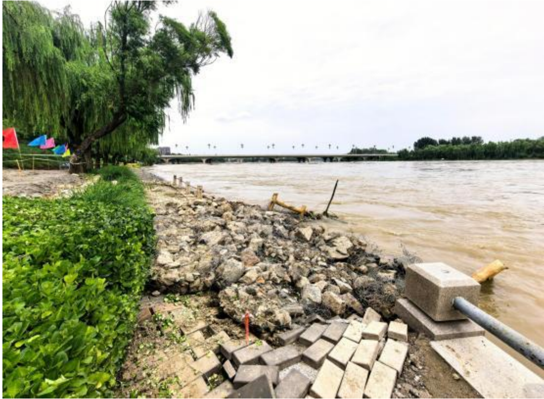
俸伯桥下游右岸挡墙
