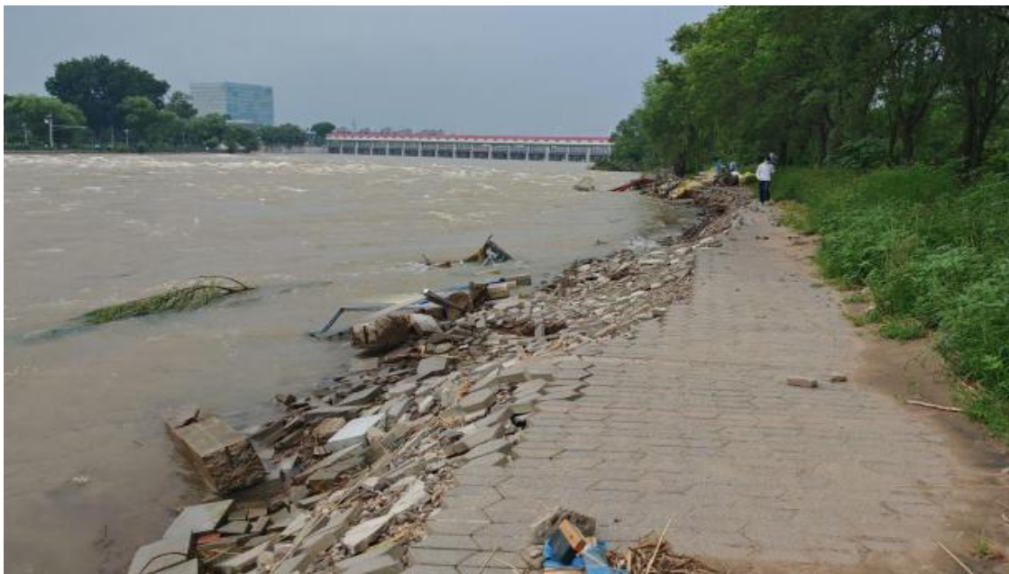
向阳闸下游左岸人行步道砖损毁
