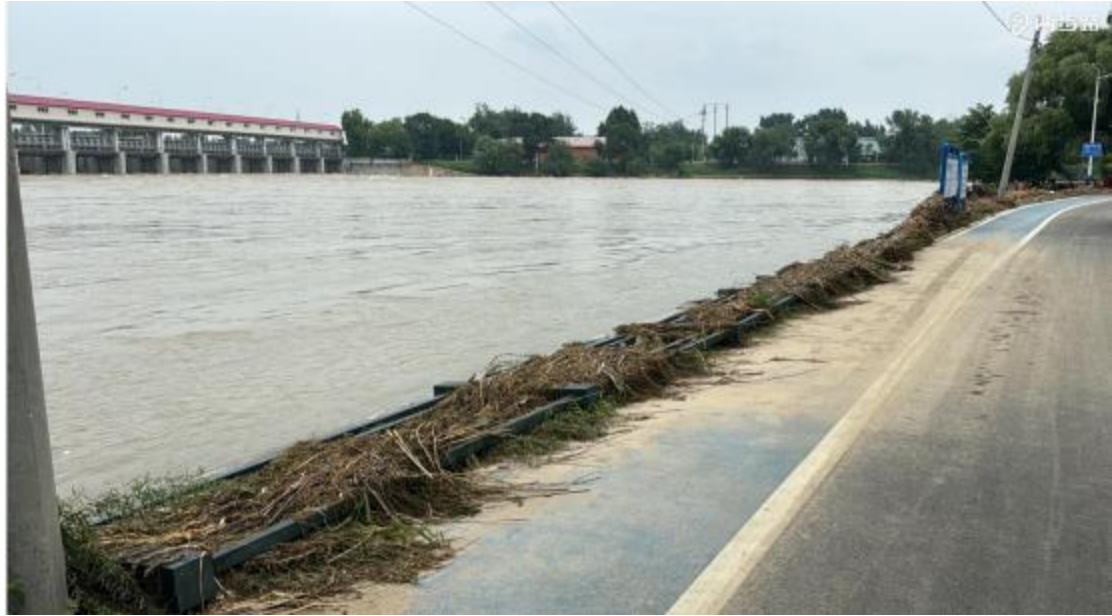
向阳闸下游右岸栏杆损毁
