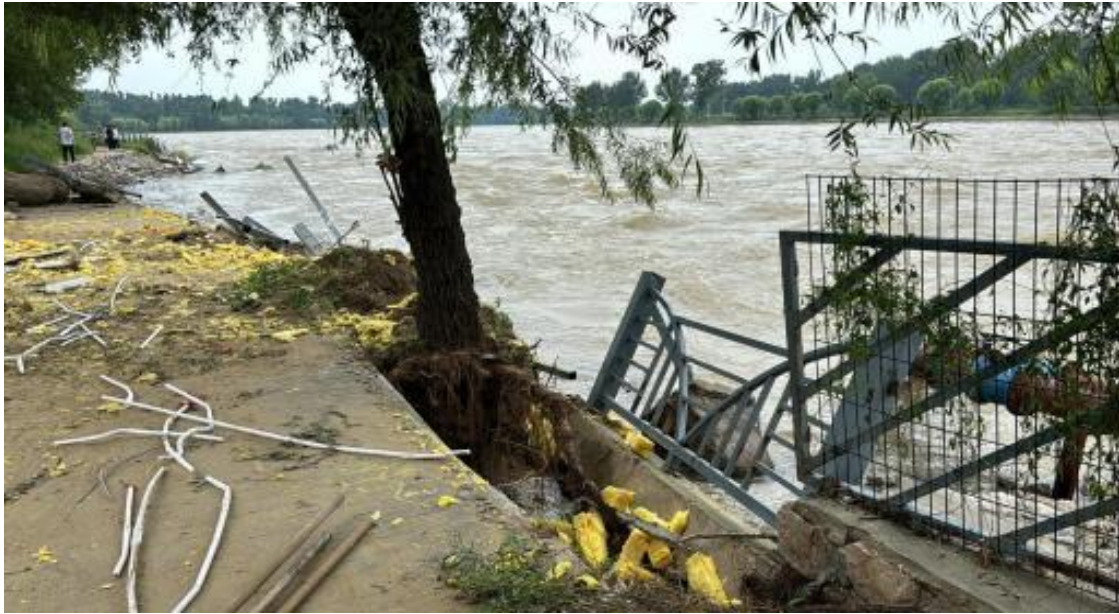
向阳闸下游左岸跌水段河坡损毁
