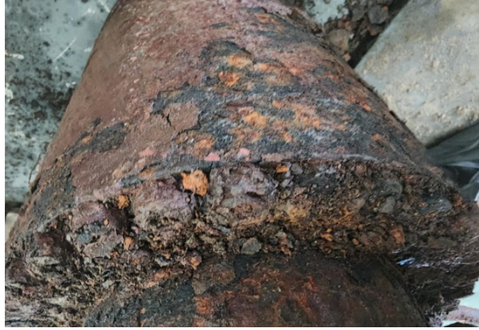
图 3 液压缸外观及各紧固件锈蚀严重
