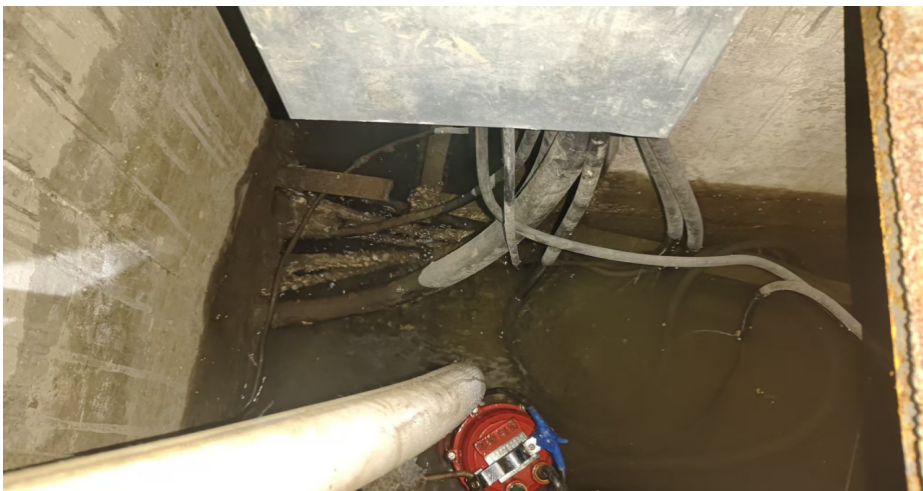
图 3.3 分水口电缆沟渗水现状
