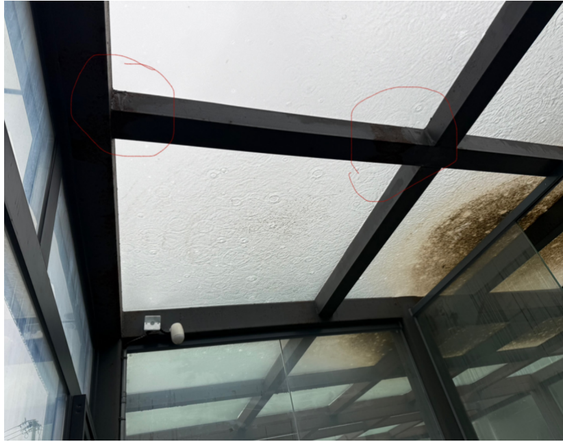
图 7.1 蝶阀室玻璃顶现状
