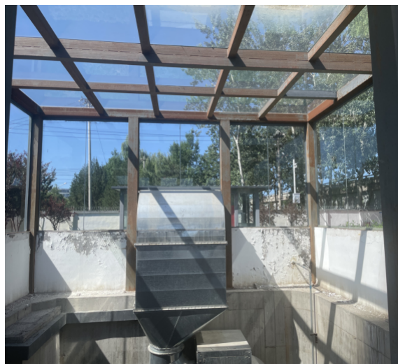
图 5.2 水源三厂蝶阀室钢结构现状
