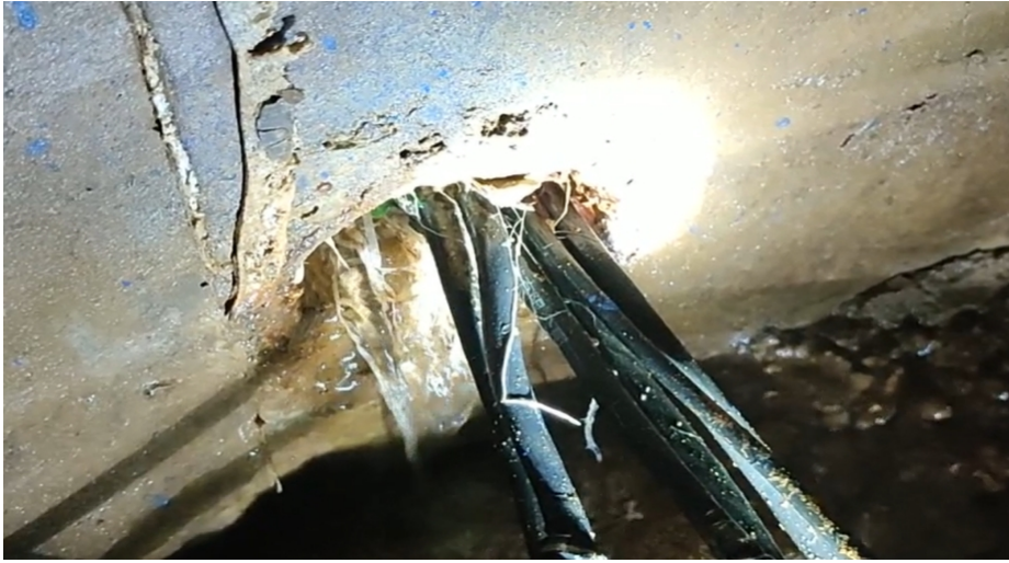
图 3.1 阀井内部现状
