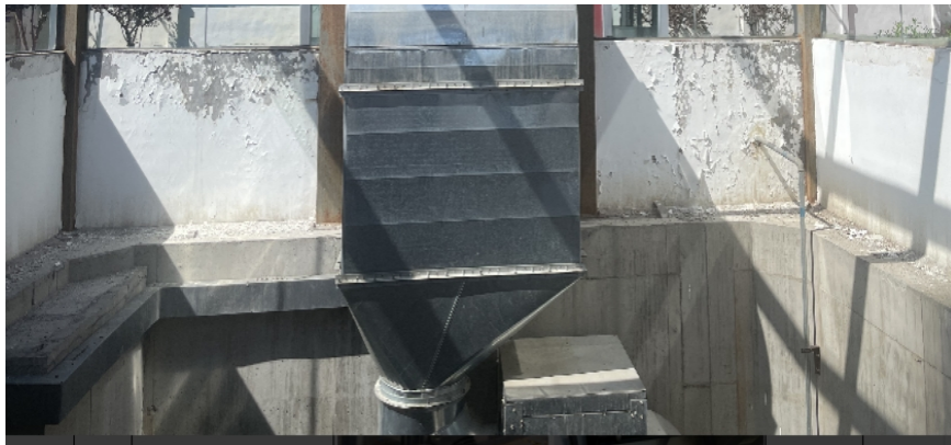
图 8.1 蝶阀室内墙现状
