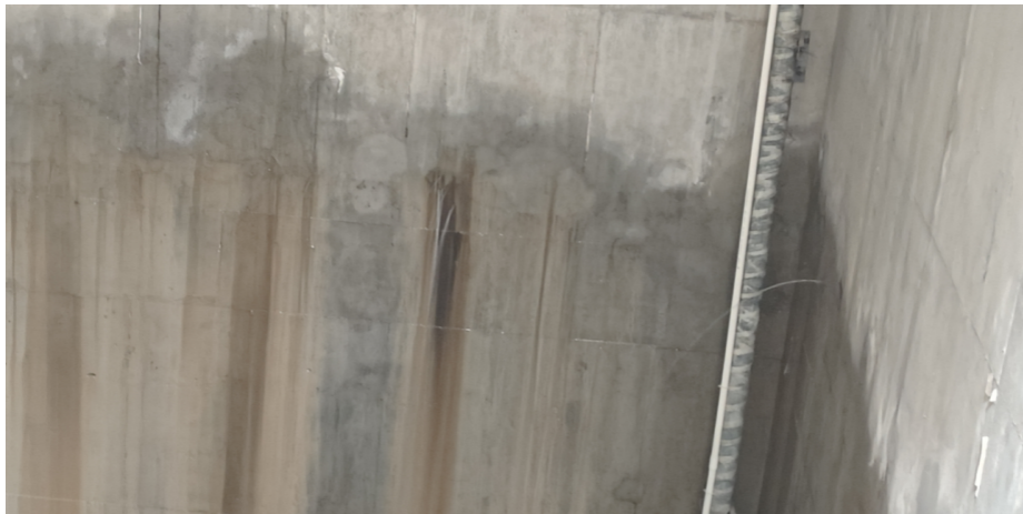
图 3.2 分水口蝶阀室渗水现状
