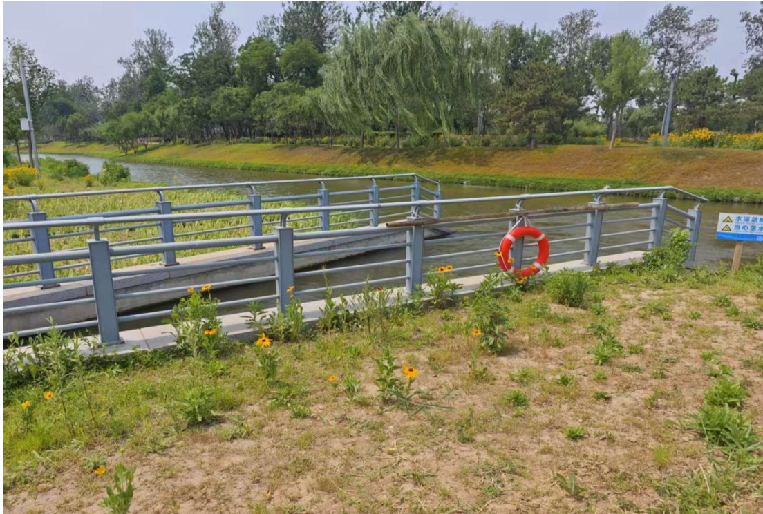
镜河两岸排水口增加栏杆统计
